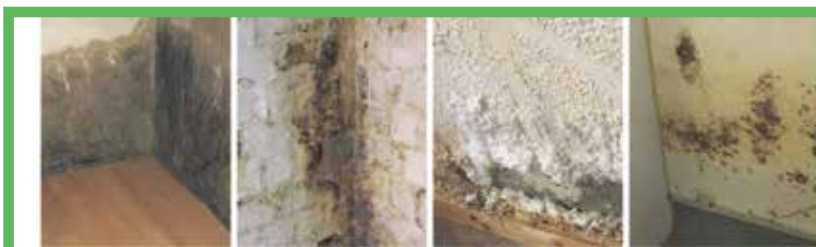
Defekte Horizontalsperre Querdurchfeuchtung Ausblühungen Schimmelbefall
