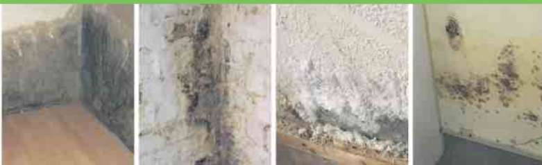
Defekte Horizontalsperre Querdurchfeuchtung Ausblühungen Schimmelbefall
