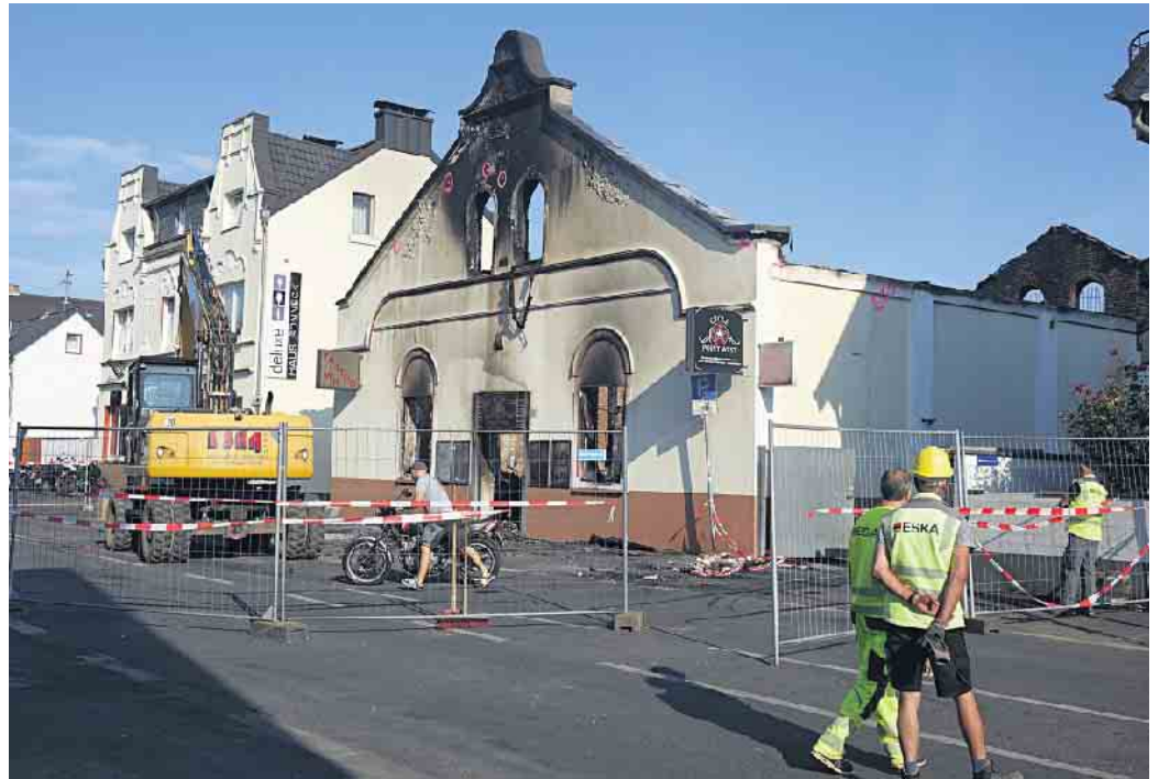
Das abgebrannte Motorradgeschäft kurz vor Beginn erster Abrissarbeiten am Dienstagmorgen. Fotos: hdp
