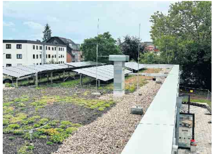
Ein Blick auf das Dach zeigt, dass mit der Kombination aus Photovoltaik und Dachbegrünung modernste Technik verbaut wurde.
