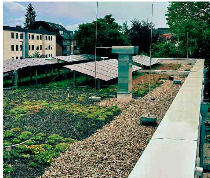
Gründach und Photovoltaikanlage auf der Kita „Rasselbande“
