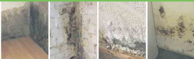
Defekte Horizontalsperre Querdurchfeuchtung Ausblühungen Schimmelbefall
