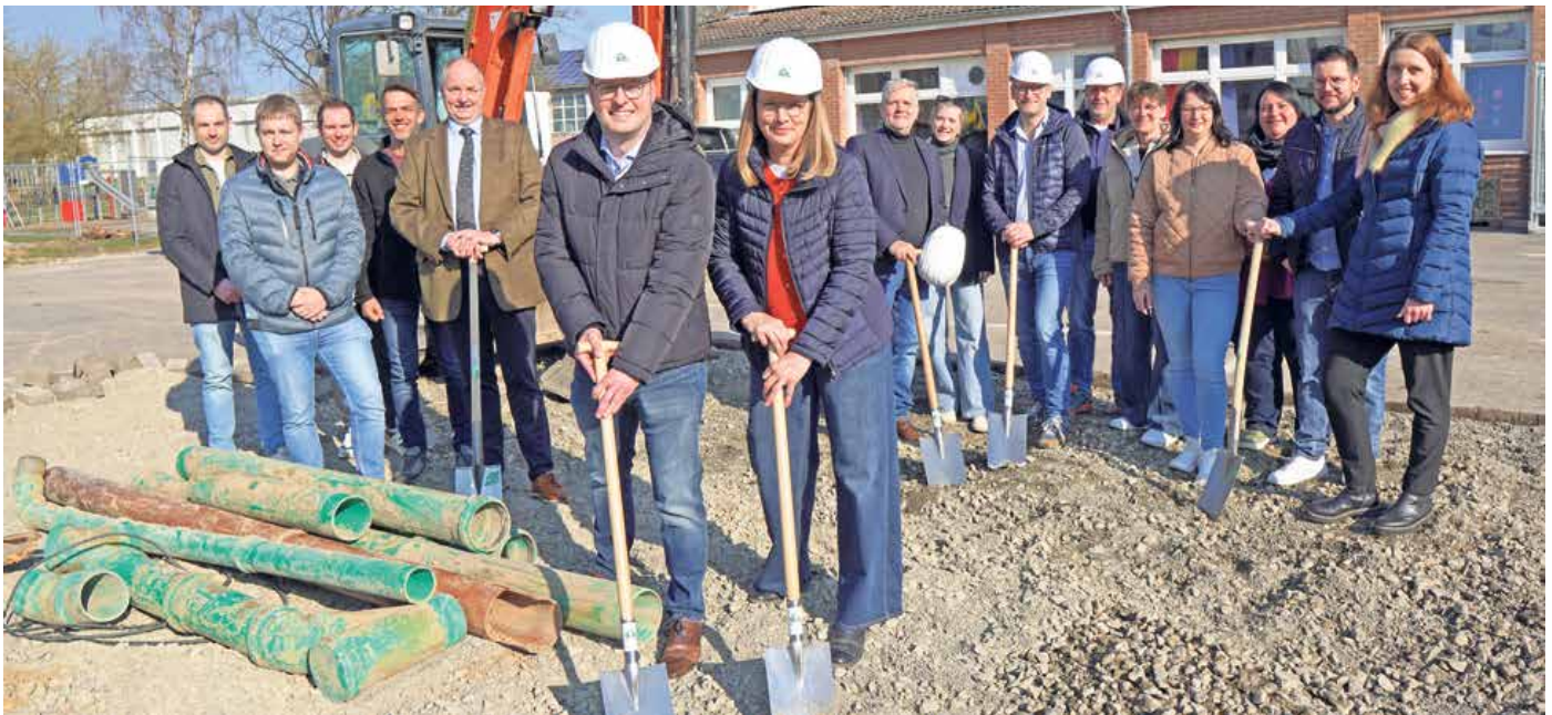
Symbolischer Spatenstich an der Gemeinschaftsgrundschule Brakel zum Erweiterungsbau der Offenen Ganztagschule (OGS): Bürgermeister Alexander Kleinschmidt (vorne, links), die Schulleiterin Sabine Bielemeier und alle weiteren Projektbeteiligten.
