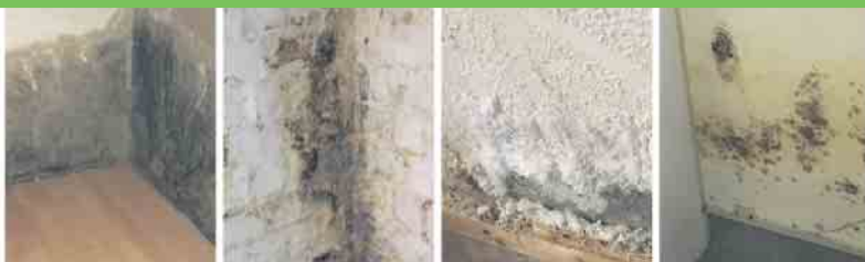
Defekte Horizontalsperre Querdurchfeuchtung Ausblühungen Schimmelbefall
