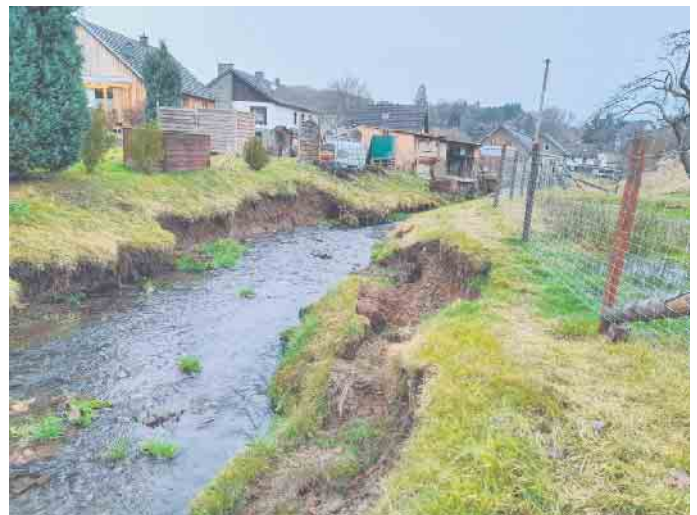
Nach dem Rückgang des Hochwassers wurde das Ausmaß der Schäden am Dreisbach sichtbar. Foto: Die Gewässer-Experten
