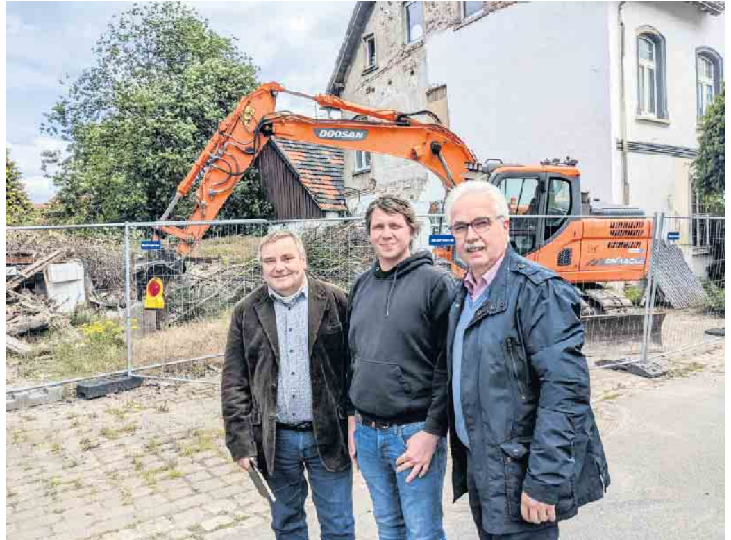
Bauamtsleiter Markus Blaschek, Abrissunternehmer Michael Mähner und Bürgermeister Norbert Hofnagel geben den Startschuss.
