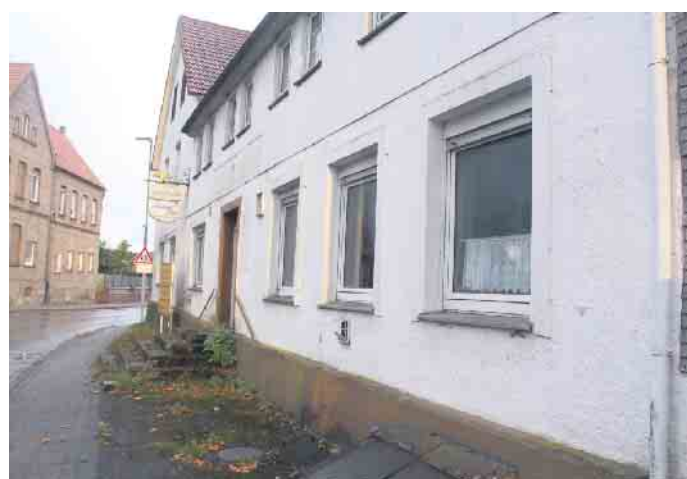
Der ehemalige Dorfkrug in Natzungen ist ein marodes Gebäude in zentraler Ortslage.
