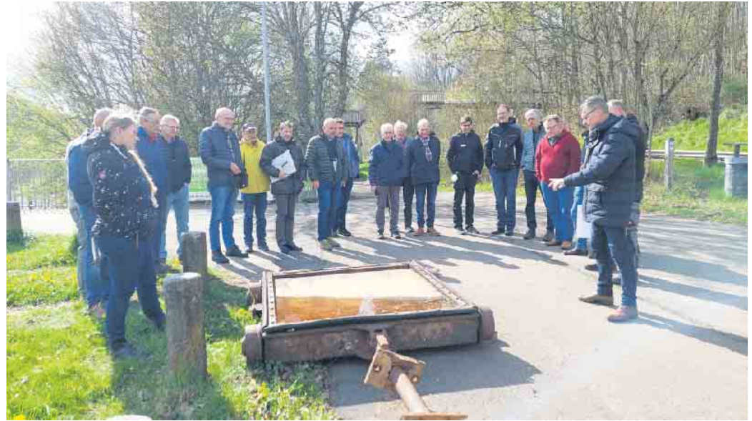
Zwei diese Ablassschieber mit entsprechender Antriebstechnik in der Talsperrenmauer müssen zunächst erneuert werden. © VG Gerolstein
