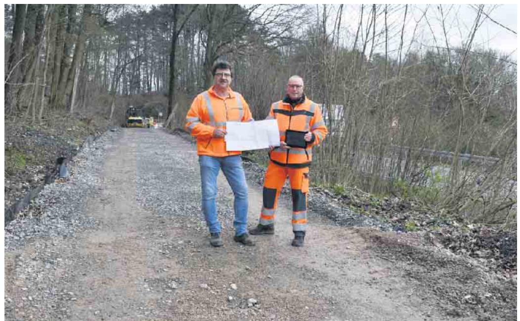
Von links: Projektleiter Richard Mede und Bernhard Tebbe (beide Straßen.NRW) auf der Baustelle „Radweg“.
