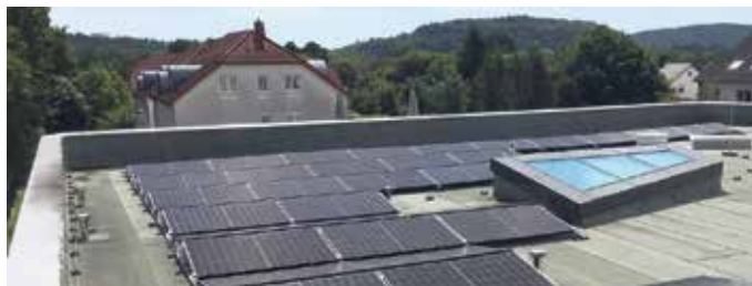
Die neue PV-Anlage auf dem Dach des Familienzentrums Miteinander
