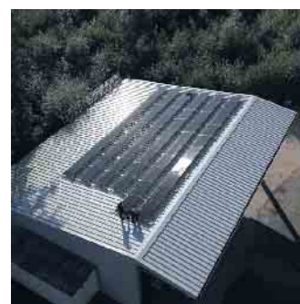
PV-Anlage auf dem Dach des Bauhofes
