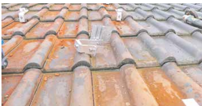
Die einzelnen Verfahrensstufen – Stufe 1 – rostfreie Haken werden auf der Dachfläche in den Sparren festgeschraubt. Fotos: Eckhard Grönemeyer
