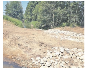
Dieser Wall war im Altlauf errichtet worden, um diesen von dem neuen Gerinne zu trennen. Foto: UHV 70
