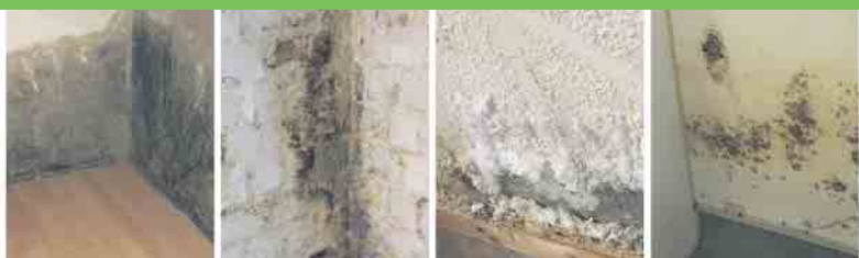
Defekte Horizontalsperre Querdurchfeuchtung Ausblühungen Schimmelbefall
