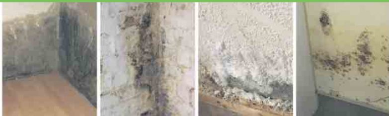
Defekte Horizontalsperre Querdurchfeuchtung Ausblühungen Schimmelbefall
