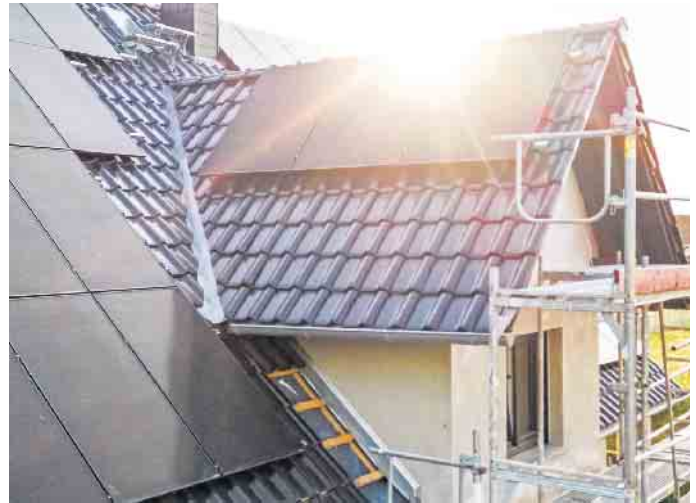
Laut einer aktuellen Studie entstehen viele Probleme an Photovoltaikanlagen durch Fehler bei der Planung und bei der Installation. Foto: DJD/Bauherren-Schutzbund/Getty Images/photoschmidt
