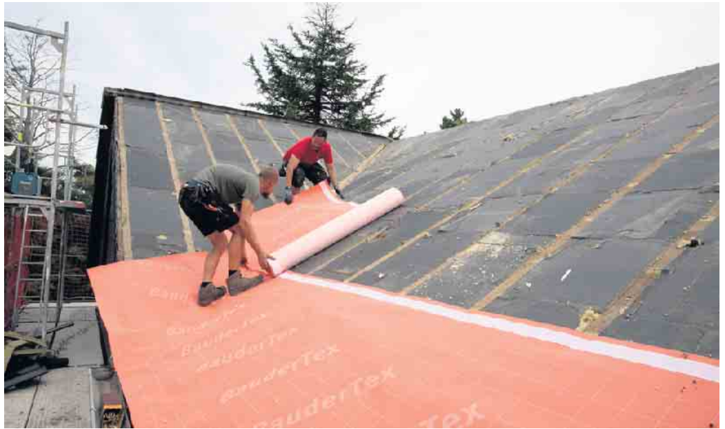
Ältere Dächer sollten regelmäßig überprüft und bei Bedarf instand gesetzt werden, bevor es beim nächsten Sturm zu teuren Schäden kommt. Foto: DJD/Paul Bauder/Michael Hauler
