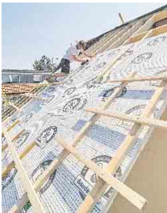
Ein professioneller Dachaufbau mit Dämmung schützt die darunter liegende Bausubstanz und trägt zudem zum Energiesparen bei. Foto: DJD/Paul Bauder/www.michaelgallner.com
