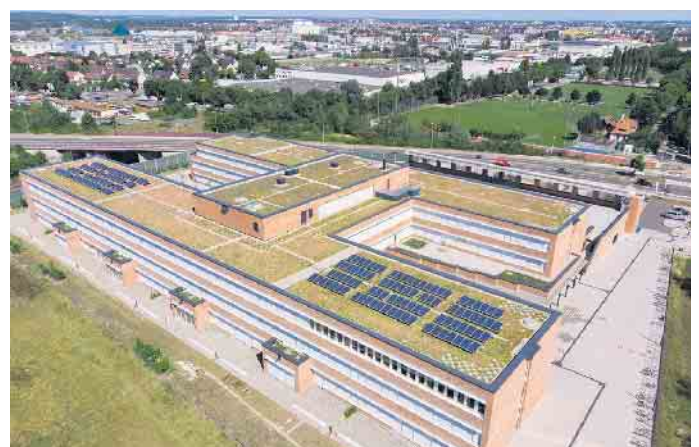
Große Flachdächer wie hier auf einer Realschule in Nürnberg eignen sich sowohl zur Begrünung als auch zur Stromgewinnung. Foto: djd/Paul Bauder/Klaus-Reiner Klebe
