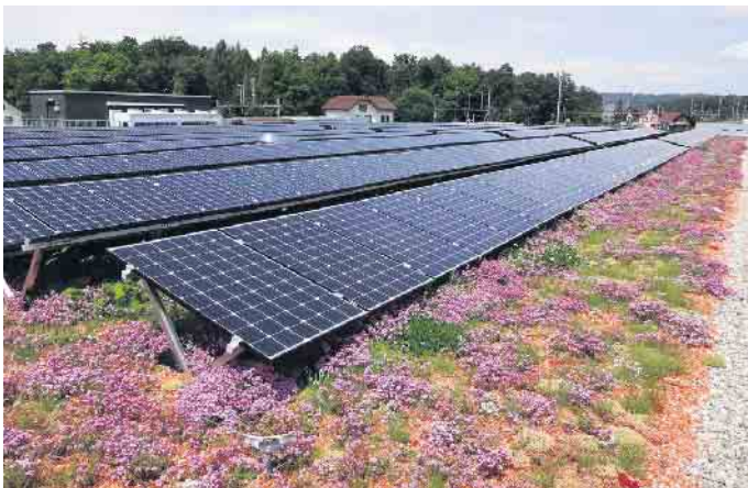
Solare Technik und eine Dachbegrünung: Diese Kombination ist gleichermaßen ökologisch als auch wirtschaftlich sinnvoll. Foto: djd/Paul Bauder
