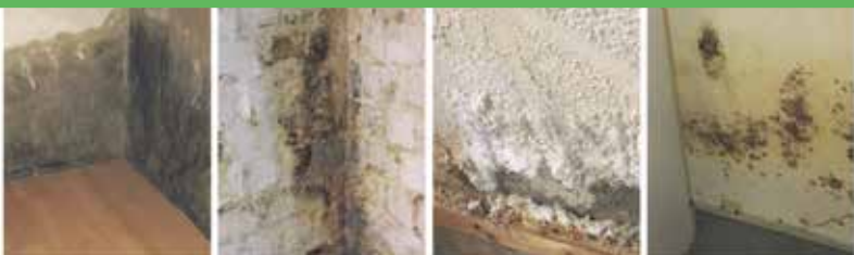
Defekte Horizontalsperre Querdurchfeuchtung Ausblühungen Schimmelbefall
