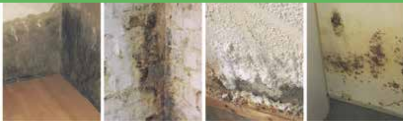
Defekte Horizontalsperre Querdurchfeuchtung Ausblühungen Schimmelbefall
