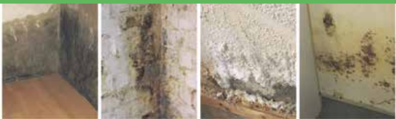
Defekte Horizontalsperre Querdurchfeuchtung Ausblühungen Schimmelbefall
