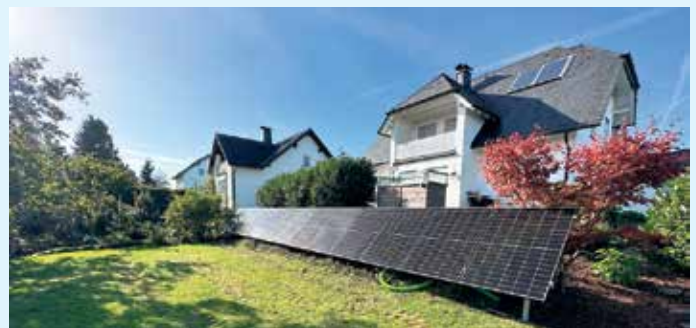
Eine Photovoltaikanlage muss nicht zwingend auf einem Dach montiert werden.
