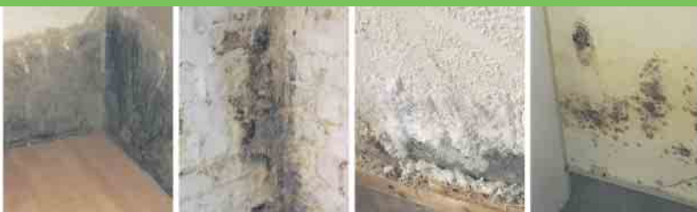
Defekte Horizontalsperre Querdurchfeuchtung Ausblühungen Schimmelbefall
