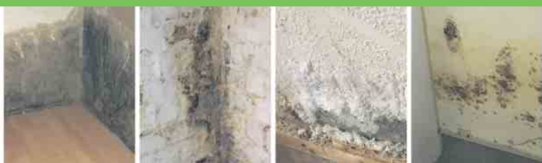
Defekte Horizontalsperre Querdurchfeuchtung Ausblühungen Schimmelbefall
