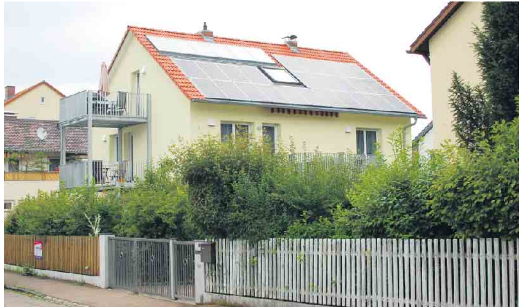
Bei der Planung einer PV-Anlage auf dem Eigenheim sollte auch der Zustand der Dachkonstruktion und -dämmung unter die Lupe genommen werden. Foto: DJD/puren
