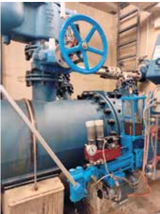
Rohre, Ventile und Absperrschieber ermöglichen den sicheren Betrieb.
