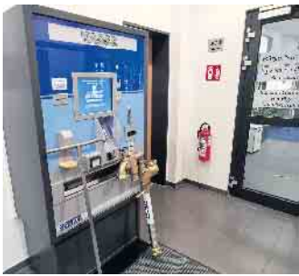
Wer ein Standrohr von der Stadt Mechernich mieten möchte, kann die Bezahlung inzwischen bargeldlos am Automaten im Rathaus oder per Überweisung erledigen. Foto: Stadt Mechernich/pp/Agentur ProfiPress
