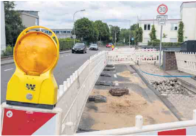
Der Rohrbruch im Juni war so massiv, dass ein größerer Abschnitt der Trinkwasserleitung in der Bruchgasse ausgetauscht werden muss. Für die Bauarbeiten muss die Straße bis zum 9. August halbseitig gesperrt werden. Foto: Ronald Larmann/pp/ProfiPress
