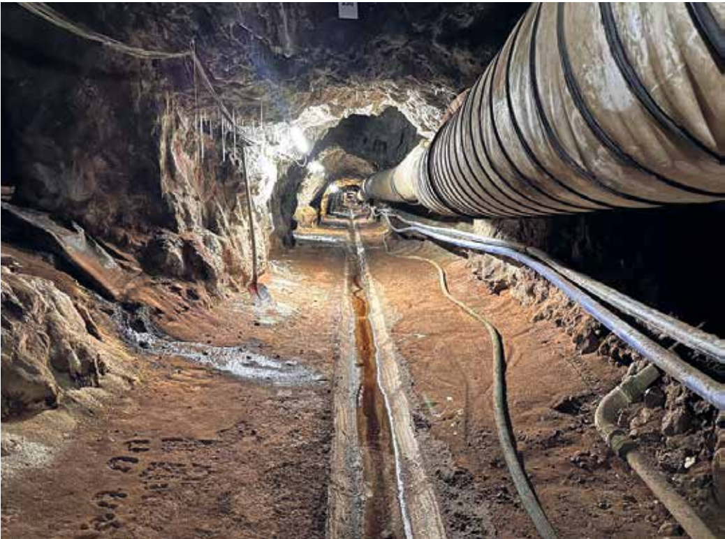
Die Rotkaulstrecke unter der früheren Zentraldeponie Mechnich: Leitungen, Sohle und technische Einbauten zeigen, wie das einst ausgetretene Sickerwasser heute unter Tage gefasst und kontrolliert zu einer eigens dafür entwickelten Umkehrosmoseanlage abgeleitet wird. Foto: Kreis Euskirchen/pp/Agentur ProfiPress
