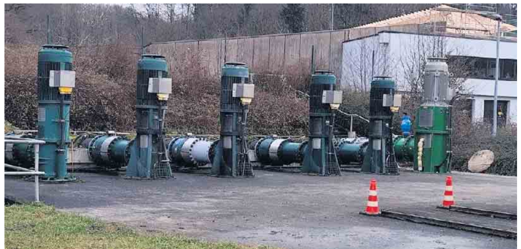
Die Pumpen, die das Wasser in die PEA holen
