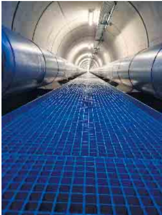
Fernwärme-Tunnel der RheinEnergie
