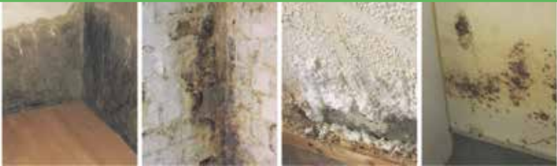
Defekte Horizontalsperre Querdurchfeuchtung Ausblühungen Schimmelbefall
