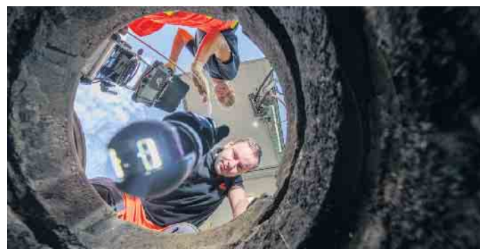
Gefragte Experten: Umwelttechnologien für Rohrleitungsnetze und Industrieanlagen kümmern sich um intakte Abwassersysteme. Foto: DJD/VDRK/Andreas Arnold
