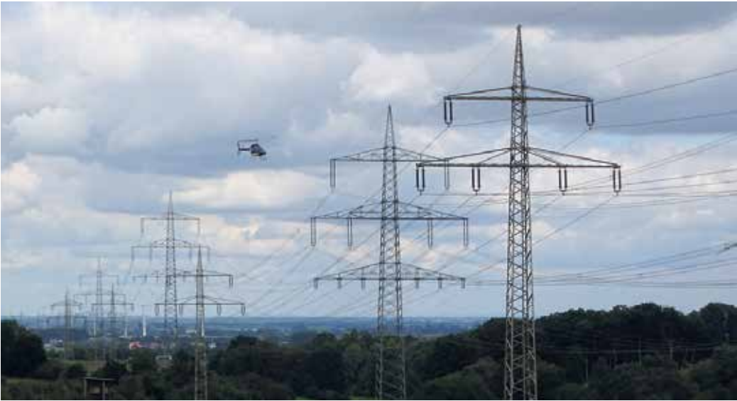
Foto: Amprion GmbH
