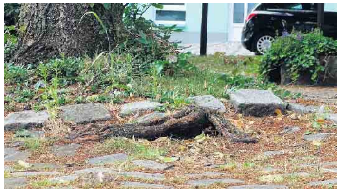
So sah es früher aus: Baumwurzeln hatten sich ihren Weg durch das Pflaster gesucht. Eine Stolperfalle für die Kirchgänger.
