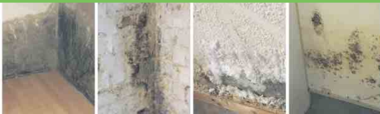
Defekte Horizontalsperre Querdurchfeuchtung Ausblühungen Schimmelbefall
