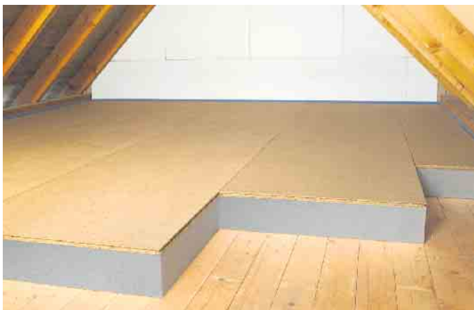
Eine professionelle Wärmedämmung verhindert, dass über den Dachboden kostspielige Heizenergie ungenutzt entweicht.
