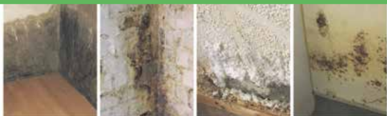
Defekte Horizontalsperre Querdurchfeuchtung Ausblühungen Schimmelbefall
