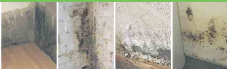
Defekte Horizontalsperre Querdurchfeuchtung Ausblühungen Schimmelbefall
