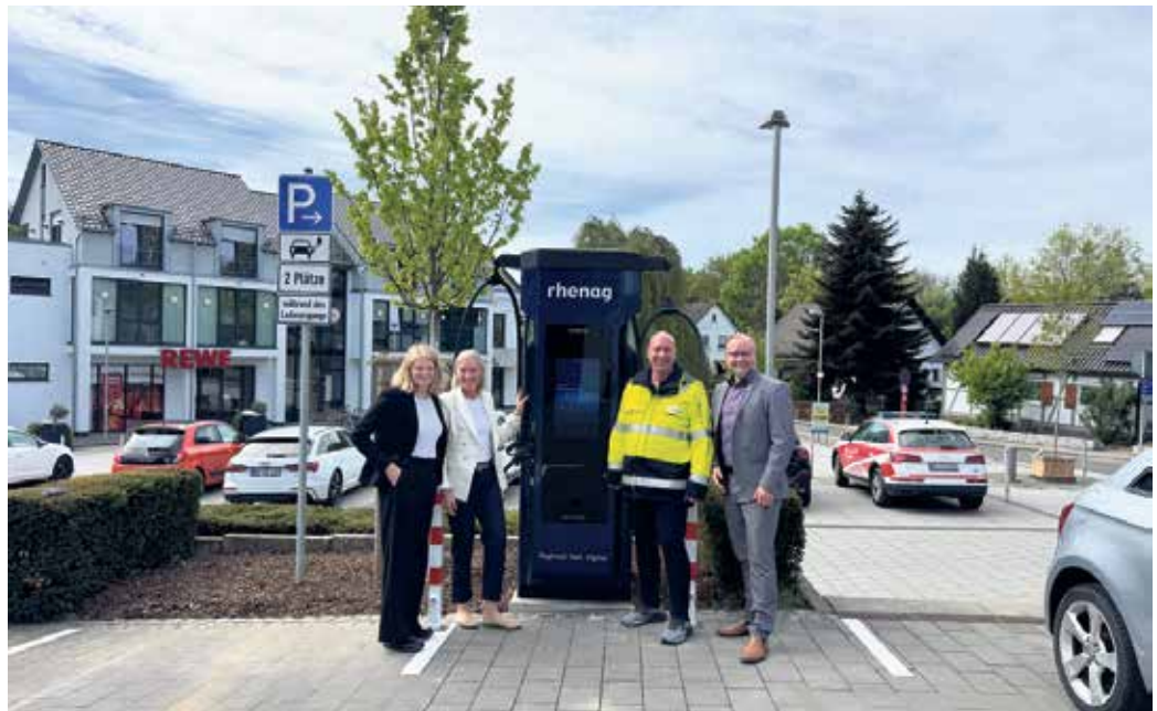
neue Schnellladesäulen in Schladern und Dattenfeld wurden installiert
