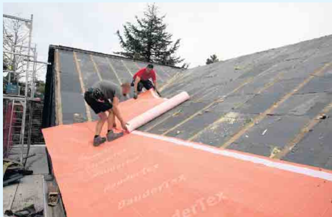
Ältere Dächer sollten regelmäßig überprüft und bei Bedarf instand gesetzt werden, bevor es beim nächsten Sturm zu teuren Schäden kommt. Foto: DJD/Paul Bauder/Michael Hauler
